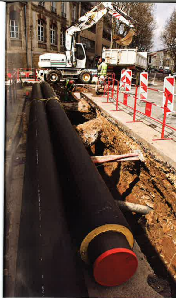
Réseau de chaleur de Dalkia à Nancy
